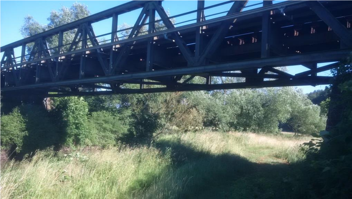
Abbildung 1: Eisenbahnbrücke über die Nidder – Ggf. kann unter der Brücke ein Steg für Radfahrer und Fußgänger angehängt werden, um die Lücke zwischen Büdesheim und Heldenbergen / Windecken zu schließen.
